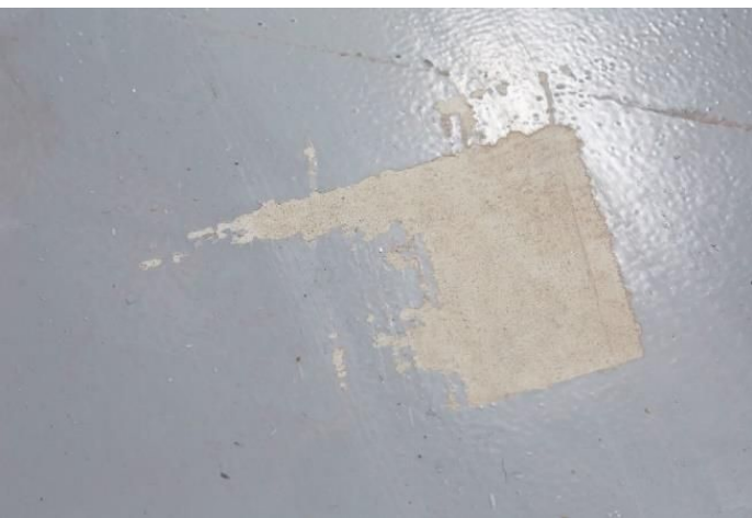
Polcrendszer telepítése által okozott károk
