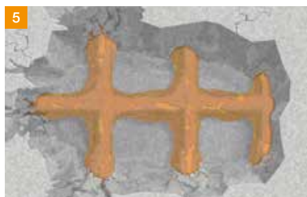
5 Ennek következménye a repedések kialakulása és a beton töredezése.
